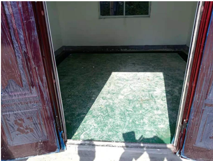
图 3-8 新的危废暂存间（内部防渗、导流沟）
