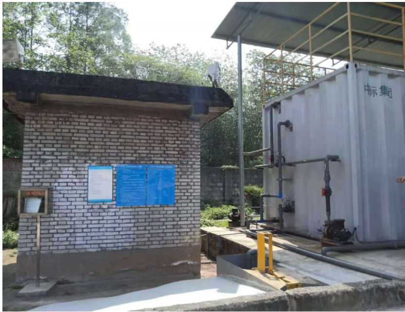
图3-4 改造后污水处理站（流量槽）
