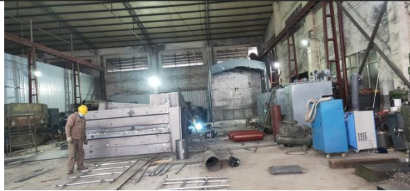
设备放置于厂房内
