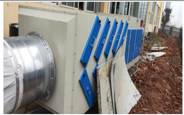
注塑废气处理装置
