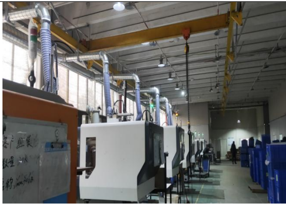
注塑废气收集管道
