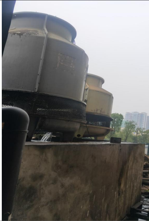
循环冷却水系统
