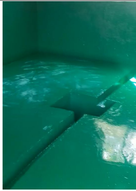
危废间设有收集沟
