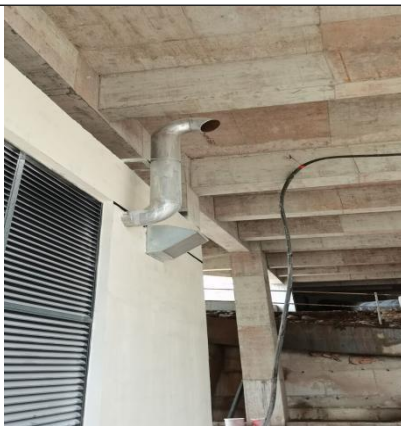
柴油发电机排气筒
