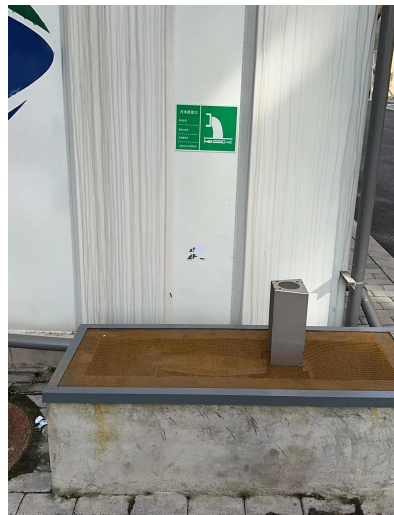
图4 废水处理设施整改后照片
